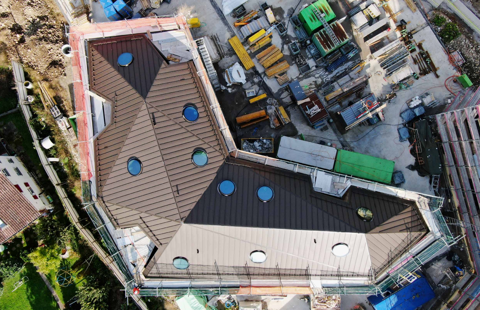
Komplexe Metalldächer wie hier bei der Überbauung Liebwylen in Schwyz sind eine Spezialität der Bless AG.
