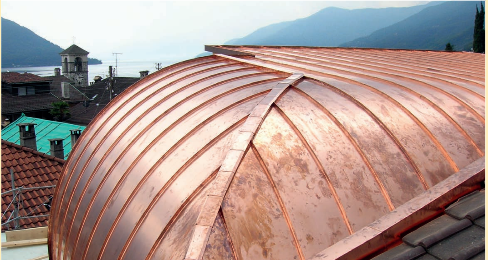
Exakte und kunstvolle Blechbearbeitung: eine runde Blechbedachung auf einem Tessiner Haus in Prato am Lago Maggiore.
